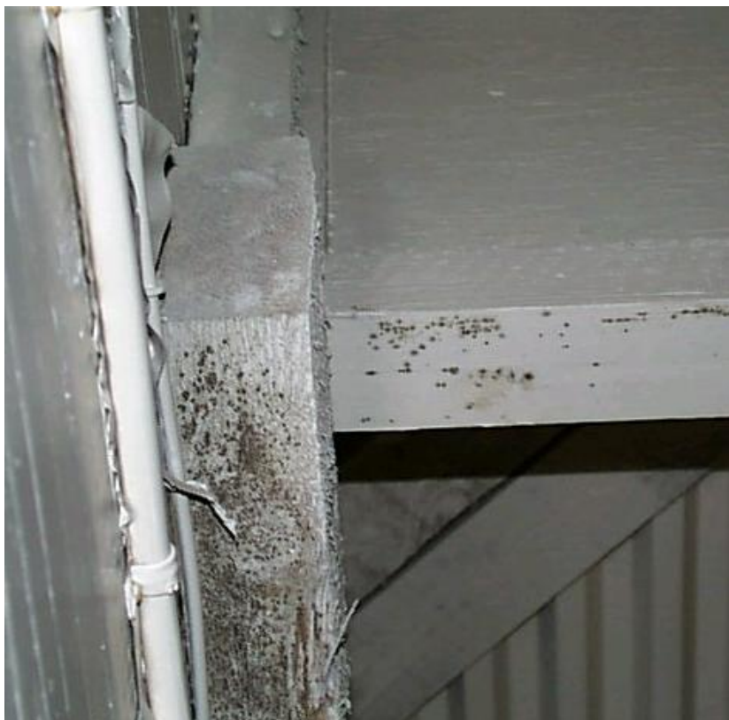
Kuva 2.4 Hometta jäähallin liimapuurakenteissa. Puuosat on käsitelty homeenestomaalilla noin 2 vuotta aikaisemmin.
